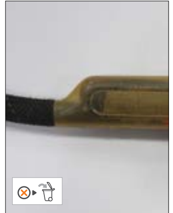
• Uszkodzona osłona plastikowa
